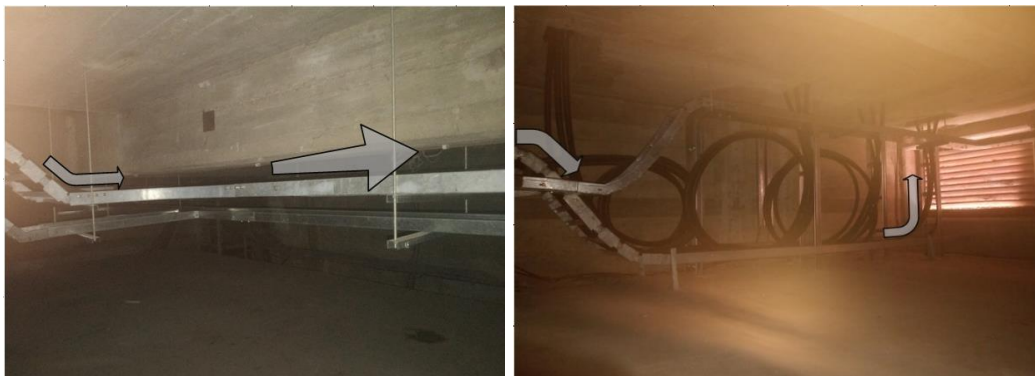
Figura 4. Ingreso a Tablero de MT, subsuelo del Anexo Santa Fe.
