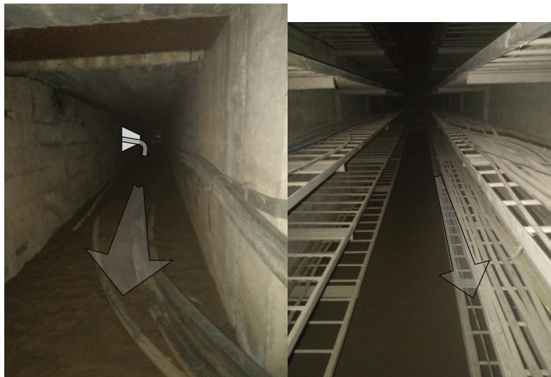
Figura 2. Recorrido del alimentador por bandejas las portacables, subsuelo del Anexo Santa Fe
