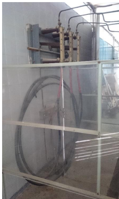
Figura 5. Acometida a Transformador en SET-Peaje Santa Fe
