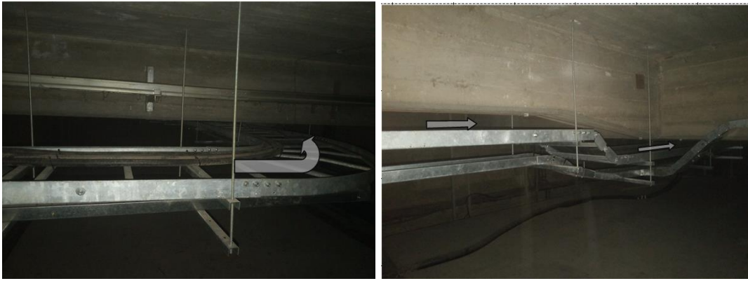
Figura 3. Recorrido del alimentador por las bandejas portacables, subsuelo del Anexo Santa Fe.
