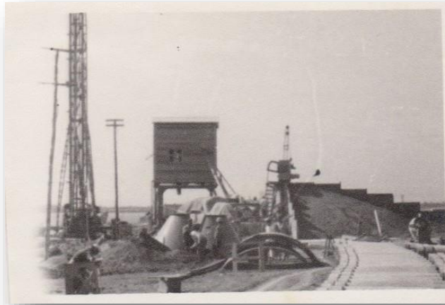
R29-01 Planta de Hormigonado
