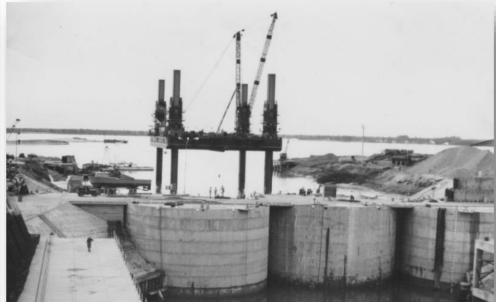
R111-22 Isla Flotante en el canal de acceso, preparada para el montaje de las prolongaciones de las columnas de apoyo
